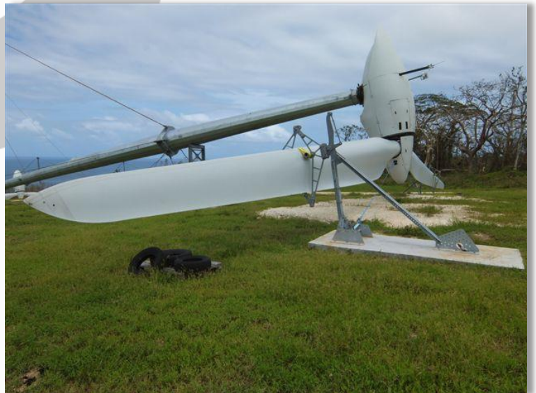
Éolienne avec équipement à l'épreuve des cyclones sur l'île d'Efate
